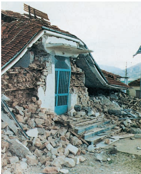
Εικόνα 27.1α: Καταστροφή από σεισμό
