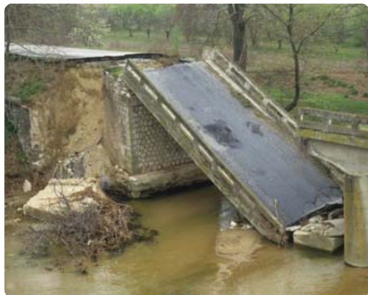
Κατάρρευση γέφυρας μετά από πλημμύρα (Λαγκαδάς).
