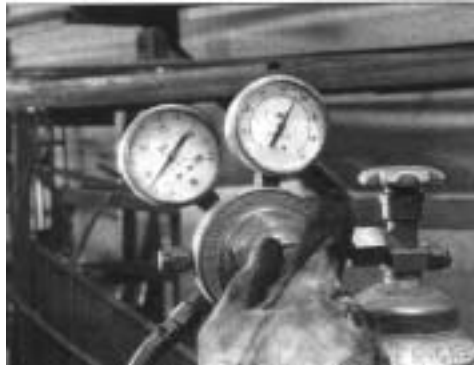
Σχήμα (5.21): Ρύθμιση της πίεσης εργασίας με το ρυθμιστικό κοχλία του μανομετρικού εκτονωτή
