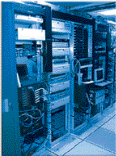
Εικ 4.1.8 Κεντρικός σταθμός διαχείρισης δικτύου ευρείας περιοχής
