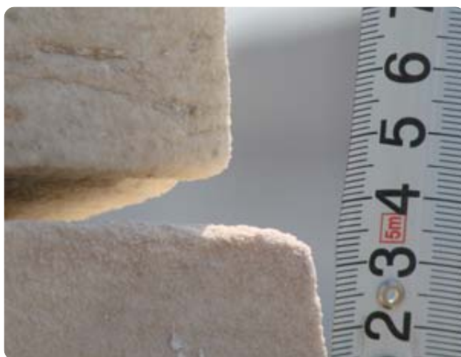
Ζαχαροποίηση και όξινη προσβολή μαρμαρίνης επιφάνειας λόγω ατμοσφαιρικής ρύπανσης. Λεπτομέρεια από το κτίριο-μνημείο της Ακαδημίας Αθηνών.
